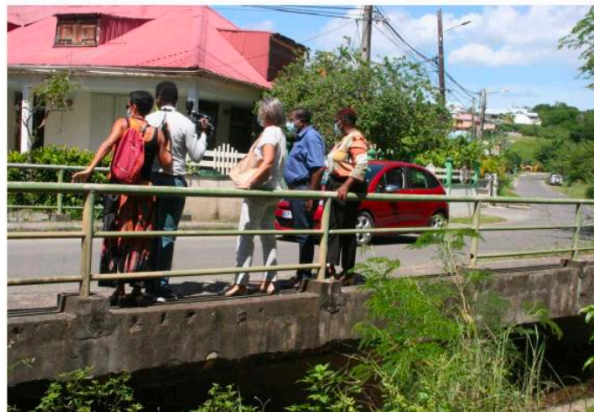
Les ponts jouent un rôle important dans l'écoulement des eaux. S'ils sont obstrués par des immondices ou branchages, cela peut avoir de graves conséquences, comme ce fut le cas sur le pont de Pavé aux Abymes en 2011.
